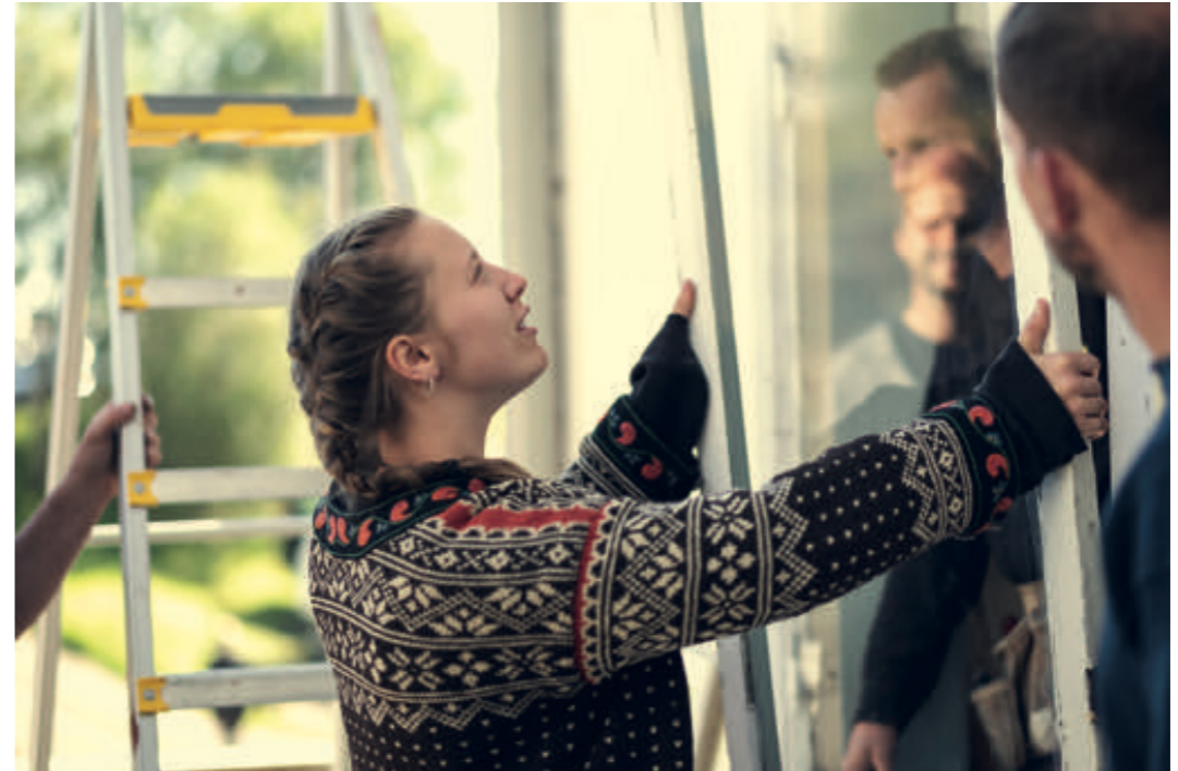
Husk å merke alle vinduene du skal ta ut med maskeringstape før du tar de ut. Foto: Bård Gundersen / Fortidsminneforeningen
