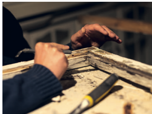
Råte. Foto: Bård Gundersen / Fortidsminneforeningen
