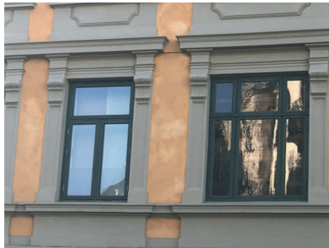
Nytt og gammelt glass. Her ser man hvordan utskiftning kan få store konsekvenser for hele fasadeuttrykket. Gamle glass har et helt annet spill i lysrefleksjonene. Nytt glass er helt flatt. Foto: Gunnhild Ryen / Kulturminnefondet.
