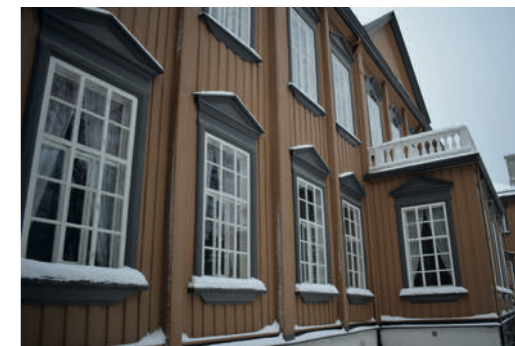
Vinduene på Stiftsgården i Trondheim er ca. 160 år gamle. Grunnet godt vedlikehold er de fremdeles i god stand. Foto: Lars Erik Haugen / Fortidsminneforeningen
