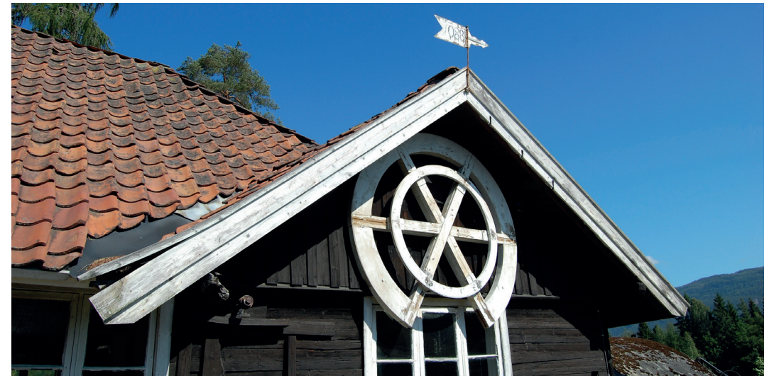
Vindski og toppbord, som har vridd seg. Foto: E. Engen/Kulturminnefondet, 2018
