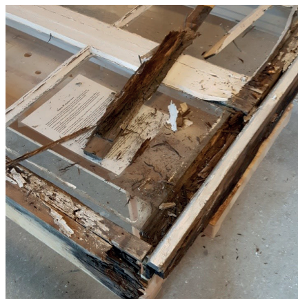
Råteskadet vindu. Foto: E. Steinsli, 2018
