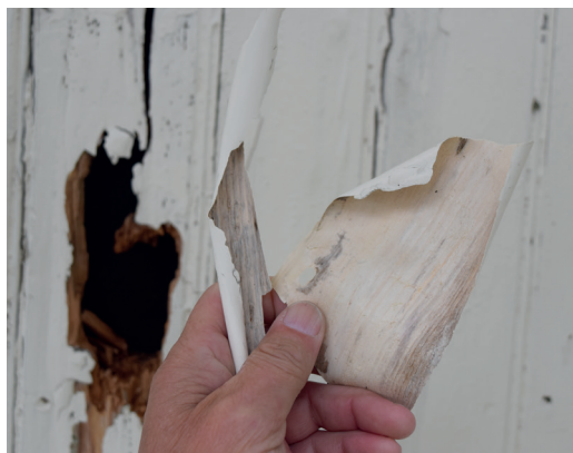
Moderne malingslag gir råteskader. Foto: E. Engen/Kulturminnefondet, 2017
