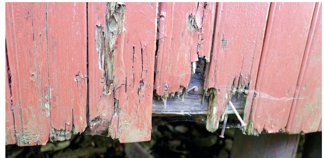
Råteskadet panel. Foto: M. Sprovin, 2018
