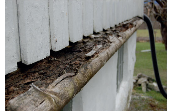
Råteskadet vannbrett. Foto: E. Engen/ Kulturminnefondet, 2016
